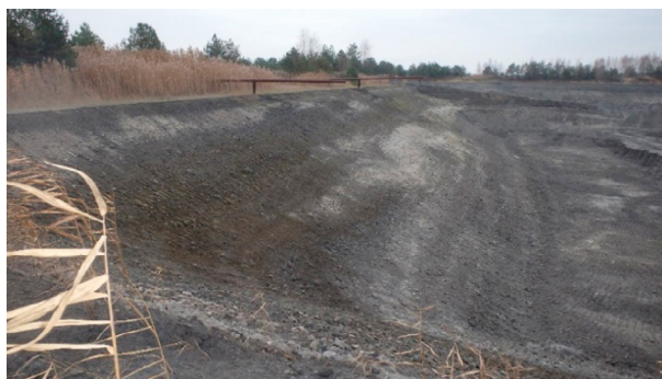
Rys. 12. Strona odwodna obwałowania głównego kwatery nr 4S-E mokrego składowiska odpadów, wykonanego z odpadów paleniskowych (listopad 2020 r.).
