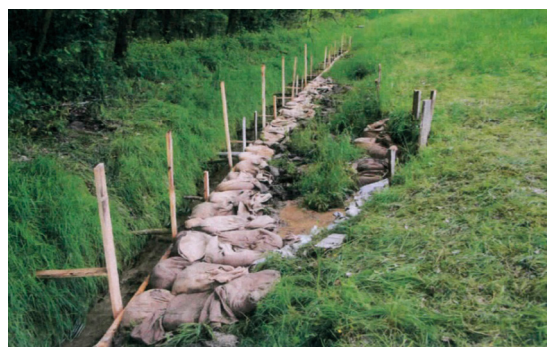
Rys. 5. Prowizoryczna naprawa uszkodzenia stopy odpowietrznej zapory z powodzi w 2010 r. [Mazurczyk i in. 2010].
