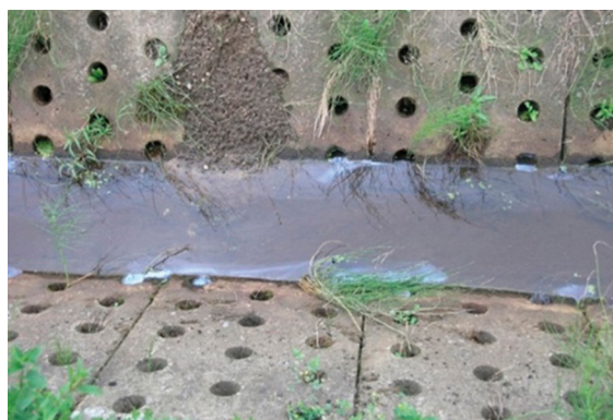
Rys. 4. Wypłukiwanie gruntu do rowu opaskowego zapory [Mazurczyk i in. 2010].
