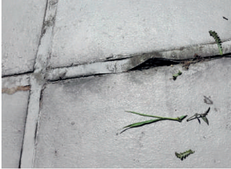
Rys. 5. Przykład zniszczenia wypełnienia dylatacji przez utratę adhezji
