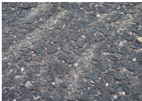
Fot. 3. Uszkodzenia zamknięcia powierzchniowego [fot. Z. Kledyński, kwiecień 2014]
