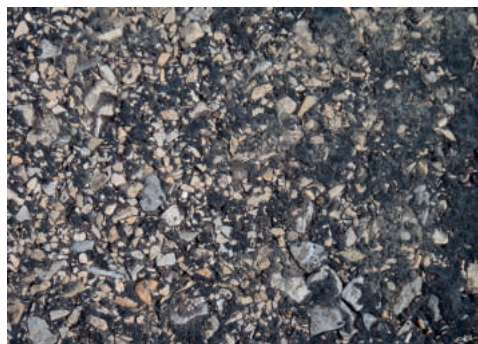
Fot. 4. Brak otuliny kruszywa [fot. Z. Kledyński, kwiecień 2014]
