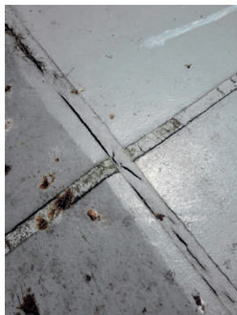
Rys. 8. Przekięcie szczelin dylatacyjnych, widoczne rysy kohezyjne i adhezyjne
