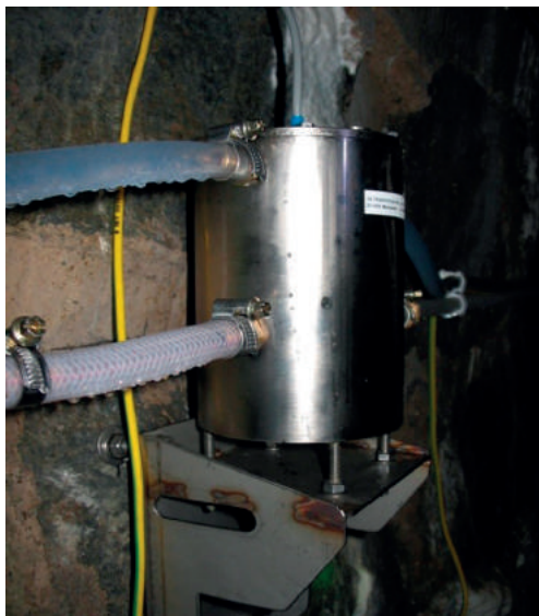
Rys. 5. Naczynie niwelatora z czujnikiem ultradźwiękowym zainstalowane na jednym z obiektów (wygląd po okresie piętnastoletniej eksploatacji w trudnych warunkach otoczenia – duża wilgotność)
