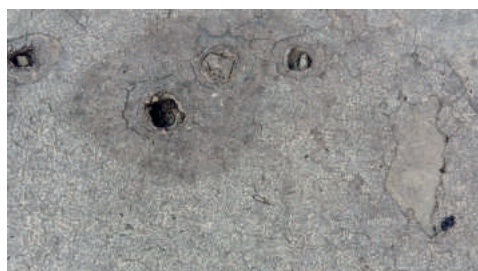
Fot. 6. Uszkodzenia warstwy szczelnej ekranu w formie tzw. ospy [fot. B. Banaszek, maj 2018]
